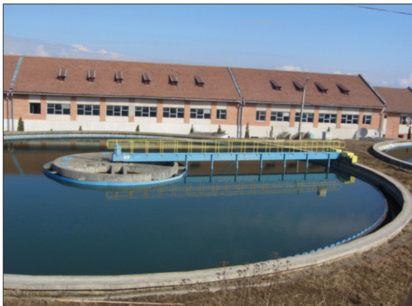
Fig. 9. Decantorul stației de epurare a apei de la Sebeșel
